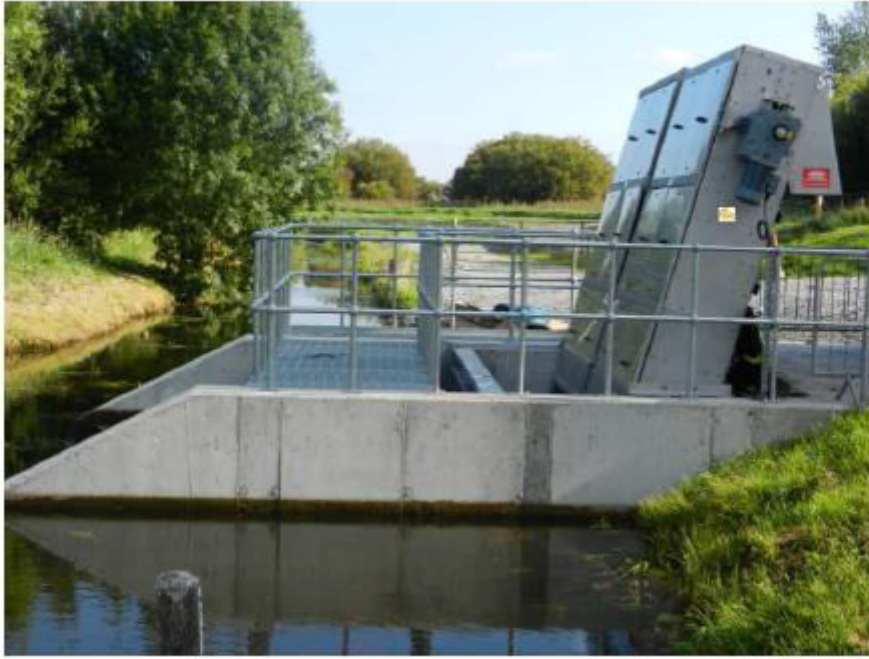
gratare verticale FLUITECO SMC instalate pentru a proteja o stație de epurare a apelor uzate
